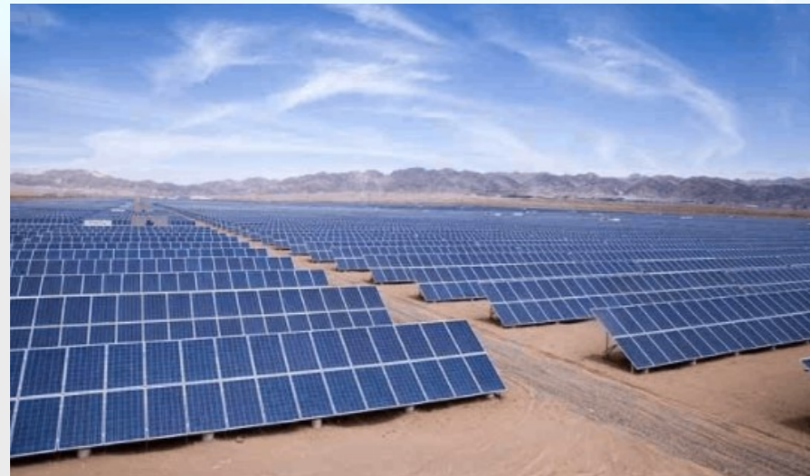
集中式光伏电站
