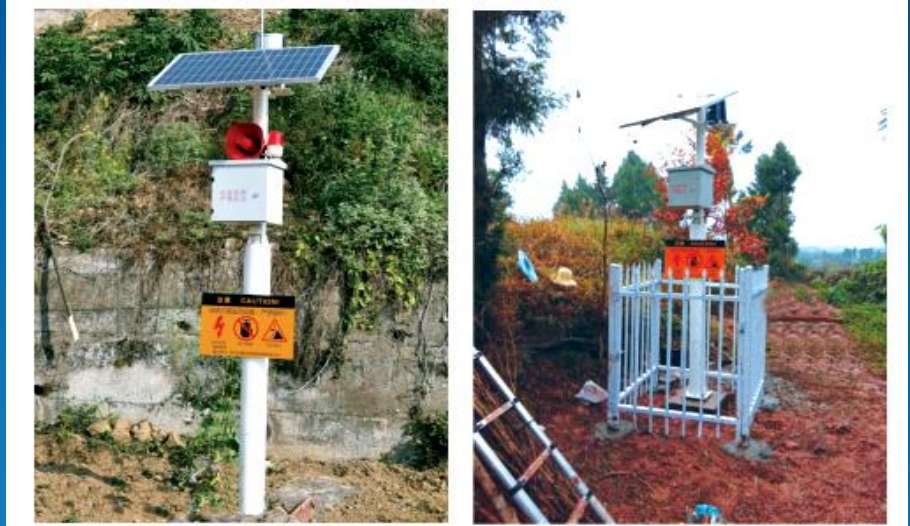
内江市中江县元村深部位移变形监测站
