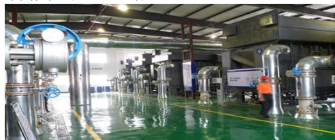
武汉市顶峰热电有限公司 40MW×6
