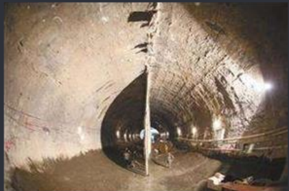
隧道智能环保开挖检测维修涂装消防
