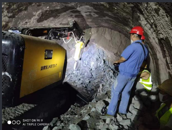
2019年10月中建五局隧道公司 长沙隧道施工中通瑞典BROKK机器人比测
