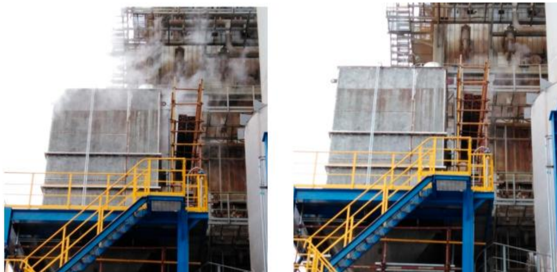
某炼油厂扩容器尾气节水除雾
