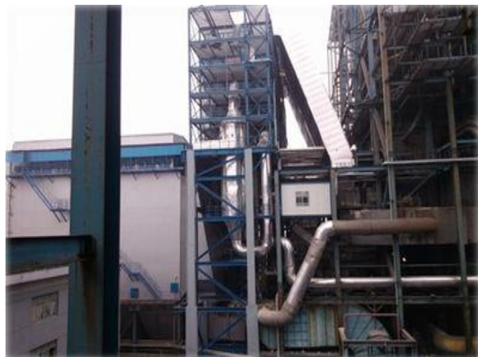
主流脱硫脱硝装置实物图
