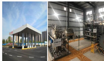
氢燃料电池汽车 现场制氢加氢站设备
