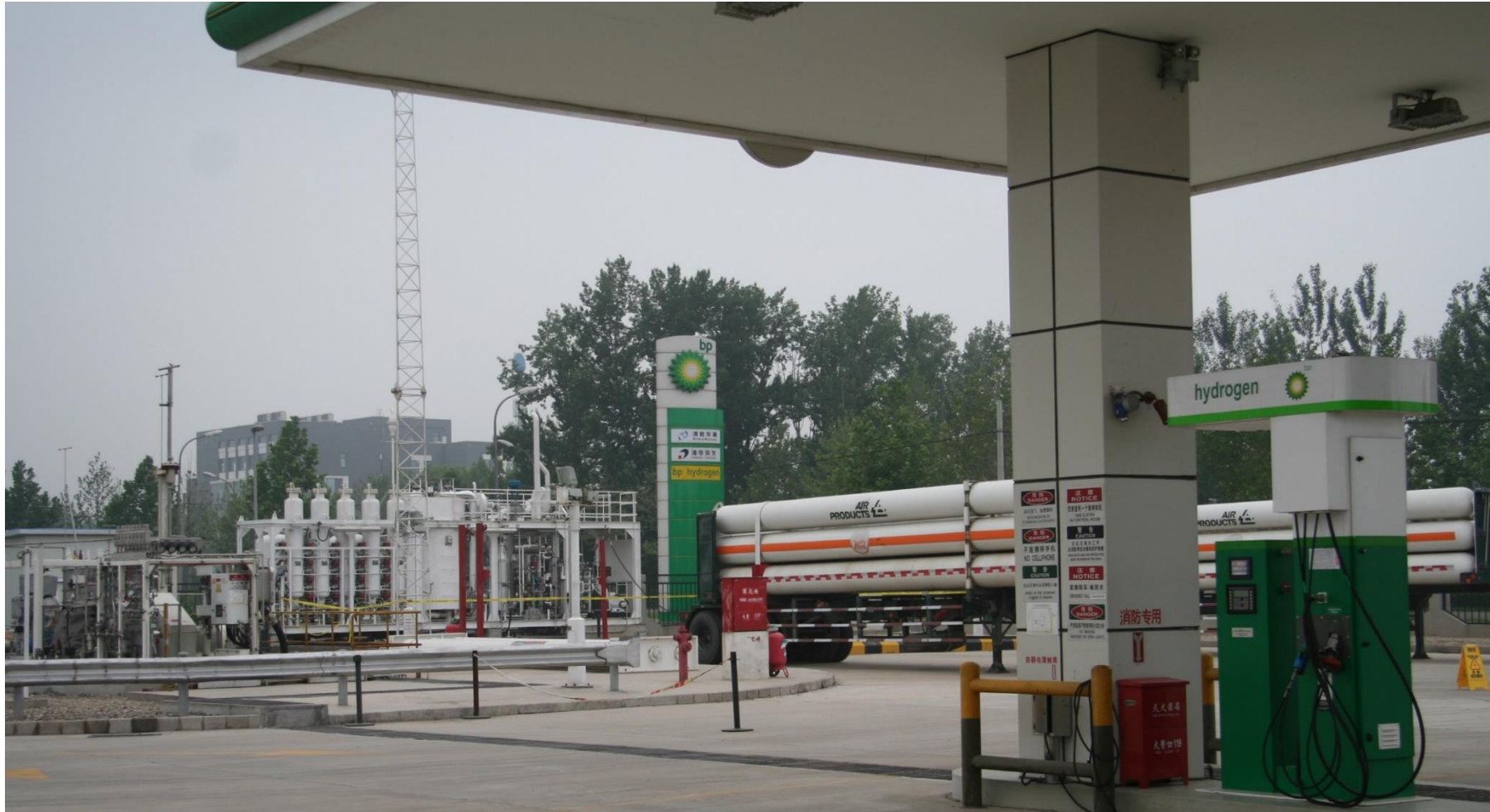
2008年北京奥运会加氢站天然气制氢项目
