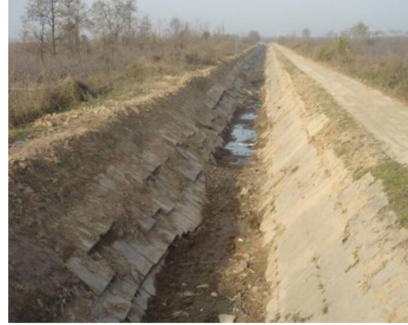
混凝土水渠冻融破坏
