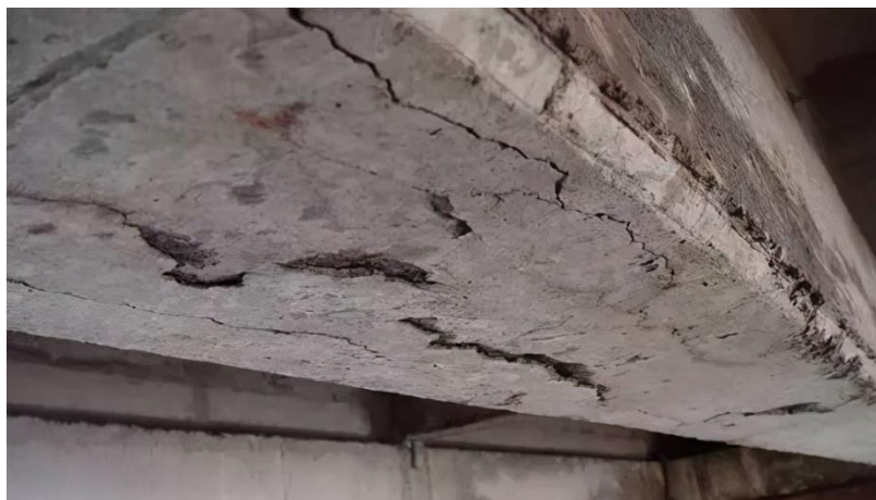
桥梁开裂影响耐久性
