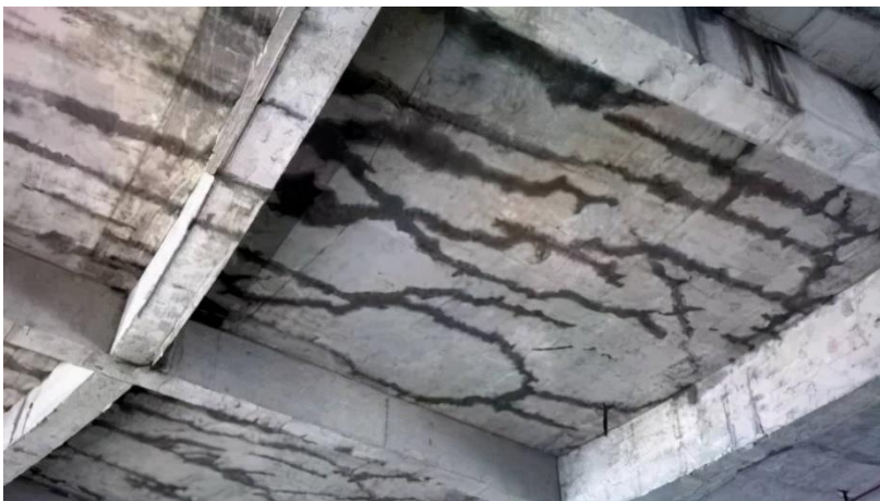
地下室顶板开裂渗水
