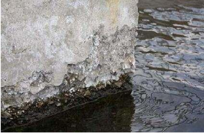
桥墩底部冻融破坏
