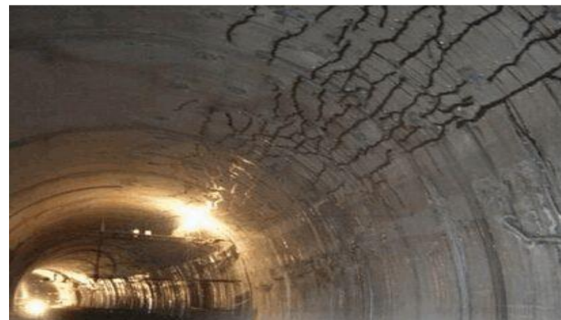
隧道衬砌开裂
