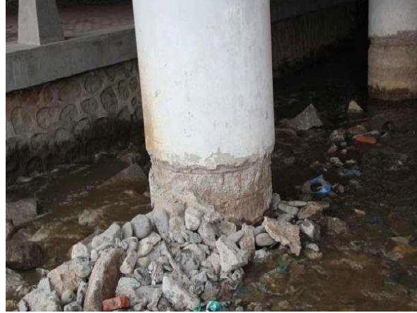
混凝土柱底部冻胀破坏
