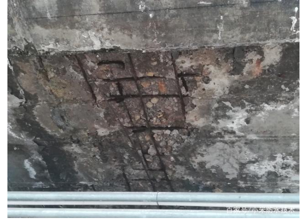
隧道衬砌冻融破坏
