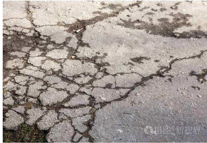
混凝土路面冻胀破坏
